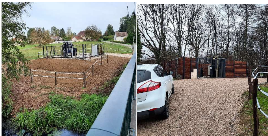
Nouveau poste de refoulement pont de la Tanche rue des Clia-Clia
