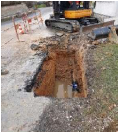
Fuites d'eau à La Vieille Loye
